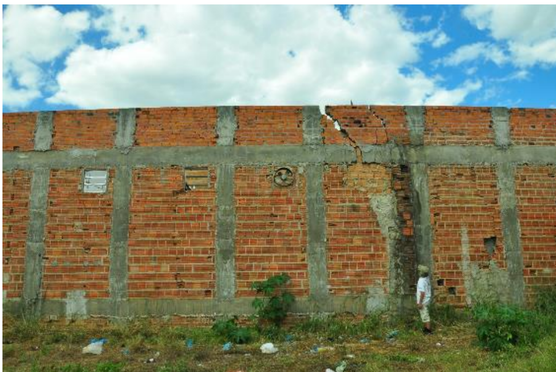
Parede com rachadura em construção abandonada, Lapão-BA. Foto; Ricardo Fraga.
