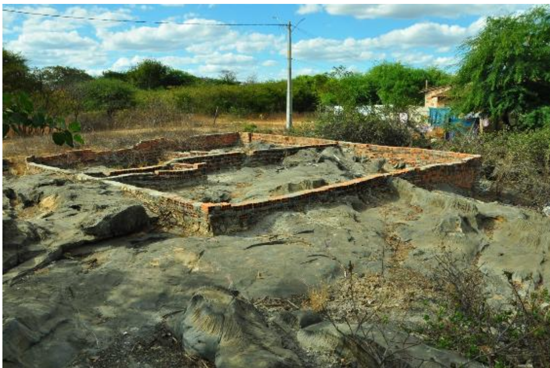
Fundação de construção abandonada sobre lajedo carbonático, Lapão-BA. Foto: Ricardo Fraga.
