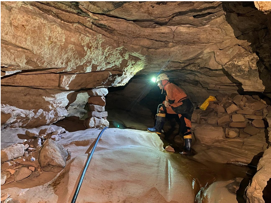
Fig. 44 – Pilar para contenção de blocos de rocha do teto, técnica frequentemente empregada pelos garimpeiros para garantir a estabilidade do local, no interior da Gruta do Canal da Fumaça. Presença de mangueiras para captação de água. Foto: Leda Zogbi.
